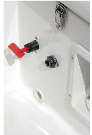
Der Batterie Hauptschalter sollte in einer geeigneten Verschaltung sitzen
